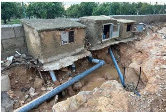
Contadores de agua de Torrent AYUNTAMIENTO TORRENT
