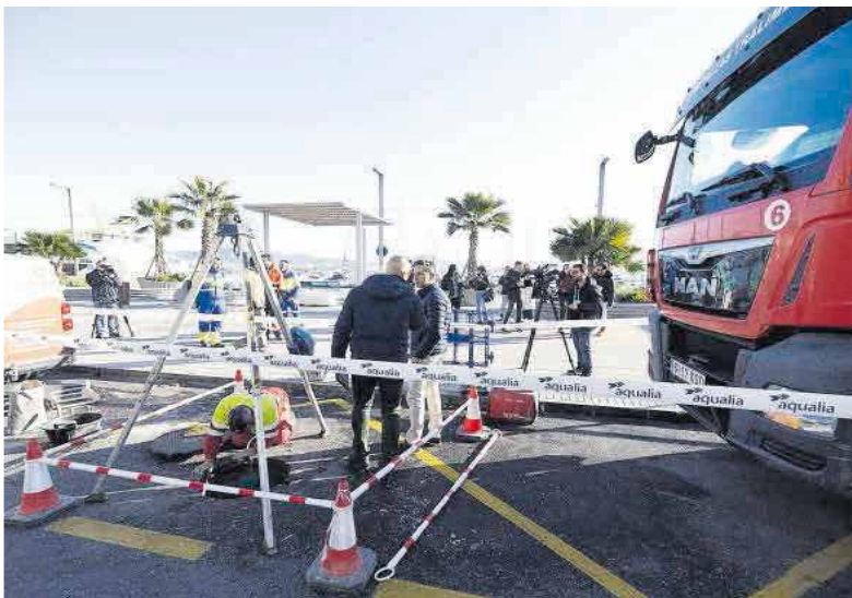
Sellado, ayer, de uno de los pozos con mayor intrusión de agua de mar.
